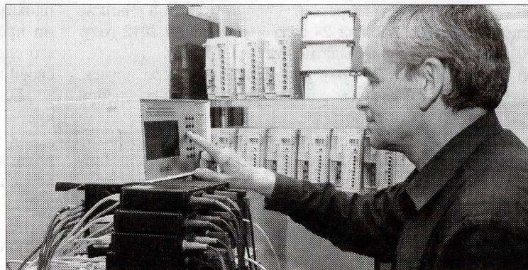
Анализатор качества электроэнергии ЦСИКЭ
